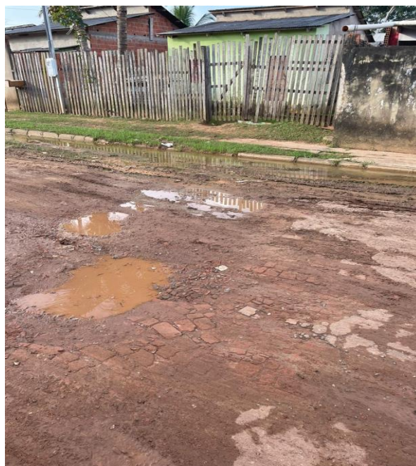
Figura 2 – A rua necessita de pavimentação.
