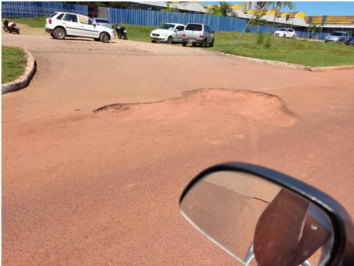
Figura 1 – Enorme buraco na entrada do estacionamento do INTO.
