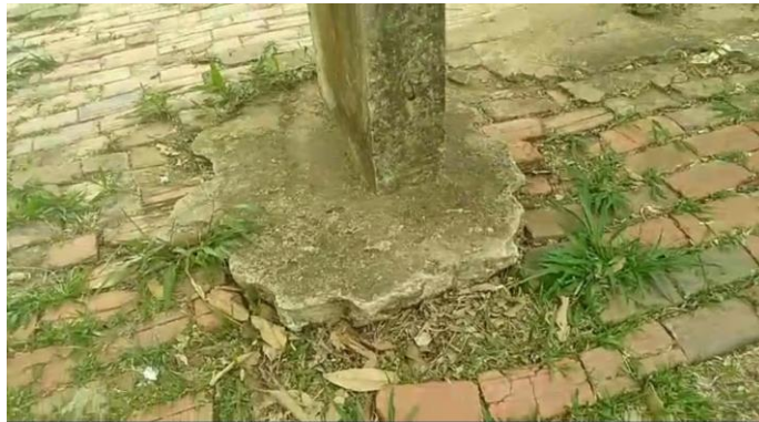
Figura 4– Parada de ônibus com risco de desabar.
