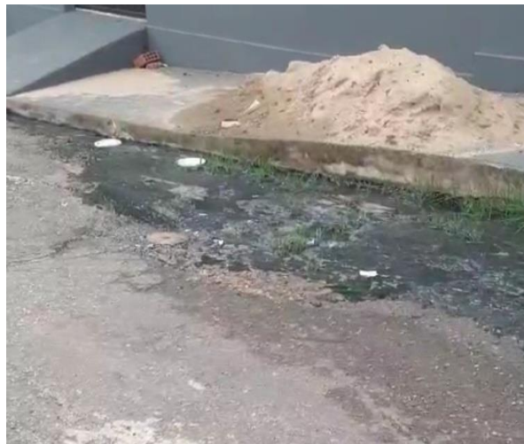
Figura 2 – Esgoto a céu aberto.
