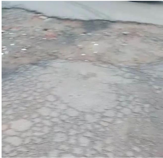
Figura 3– A rua necessita de pavimentação e calçamento.
