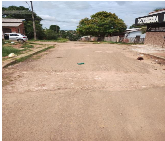
Figura 3– A rua necessita de pavimentação e calçamento.
