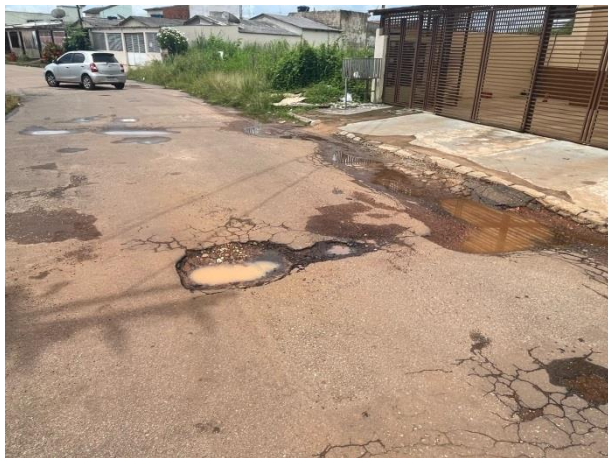
Figura 3— A rua necessita de pavimentação e calçamento.
