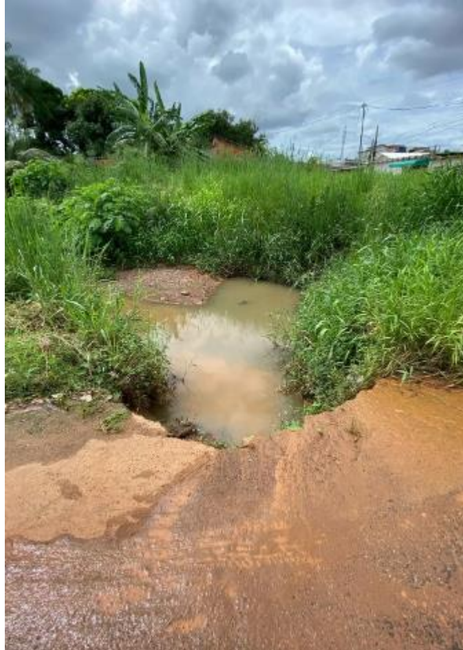
Figura 3– A rua necessita de pavimentação, criação de bueiros, calçamento e saneamento básico.
