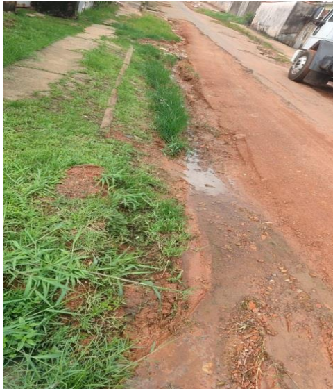
Figura 3– A rua necessita de pavimentação, calçamento e saneamento básico.
