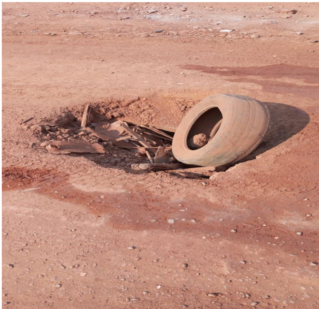
Figura 2— A rua necessita de pavimentação, saneamento básico e calçamento.
